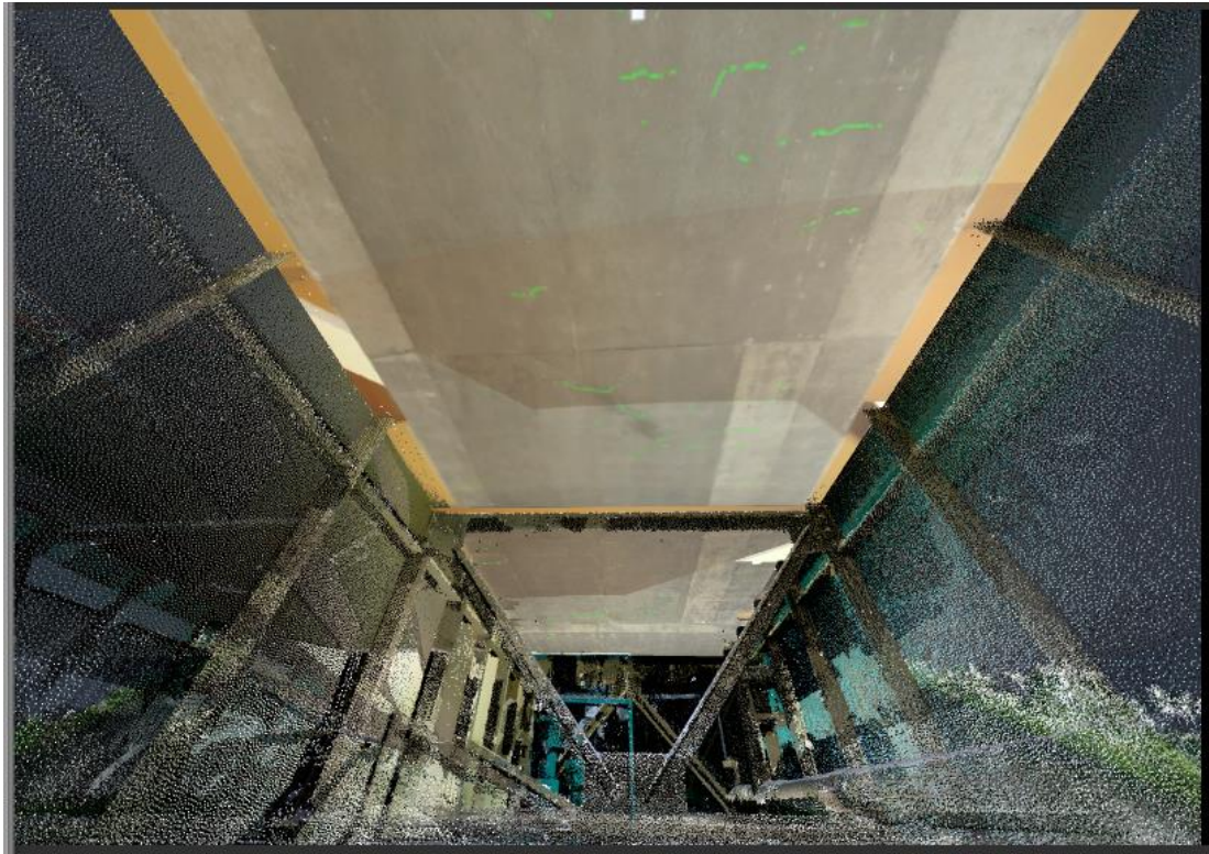
画像：橋梁の3次元点群にひび割れ画像を重畳させた画面（緑の箇所がひび割れ）
